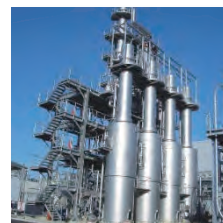
濃縮・蒸留・脱水設備
