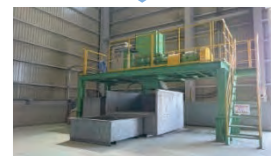
製品廃棄物破碎設備
