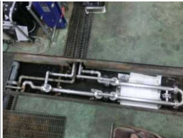
ピット内設置の熱交
