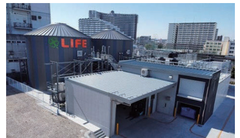
天保山プロセスセンターバイオガス発電設備
