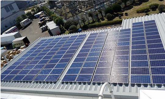
鎌倉総合工場 (2019年3月設置)
