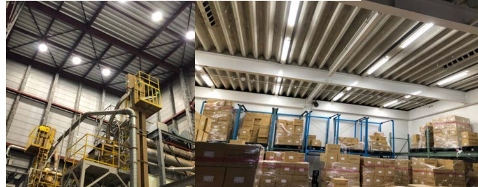
製造工場全照明LED化による電力消費量削減
