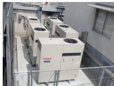
バイオガス発電機
