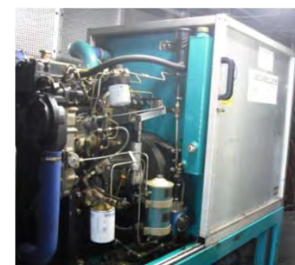
バイオガス・BDF混焼発電機
