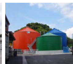
メタン発酵槽・消化液槽
