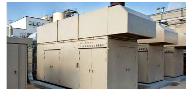
バイオガスエンジン発電機
