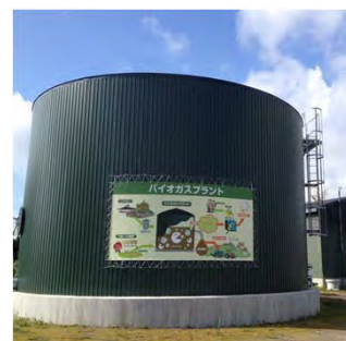
発酵機能付き貯留槽
