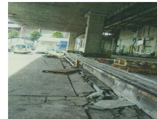
地震による施設被害
