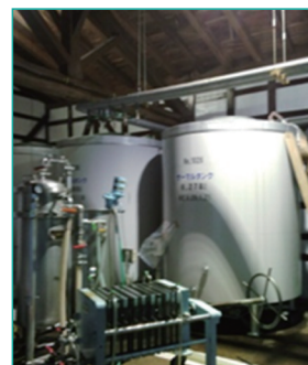
年間を通じて生酒を貯蔵 できる冷媒付きサーマル タンク設備
