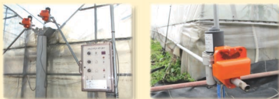
換気コントローラー・開閉巻上装置
