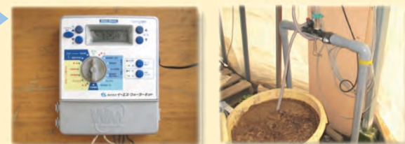
給水コントローラー・液肥との接続
