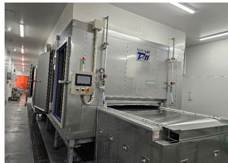
トンネルフリーザー
