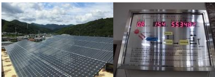
写真 1-4 南伊勢町役場南島庁舎屋上 太陽光発電システム
