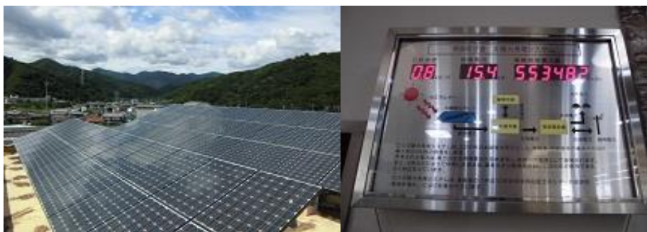
写真 1-4 南伊勢町役場南島庁舎屋上 太陽光発電システム
