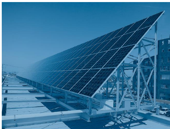
平川市役所の太陽光パネル
