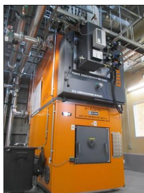
写真 1.6.1 バイオマスボイラー
