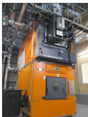
写真 1.6.1 バイオマスボイラー
