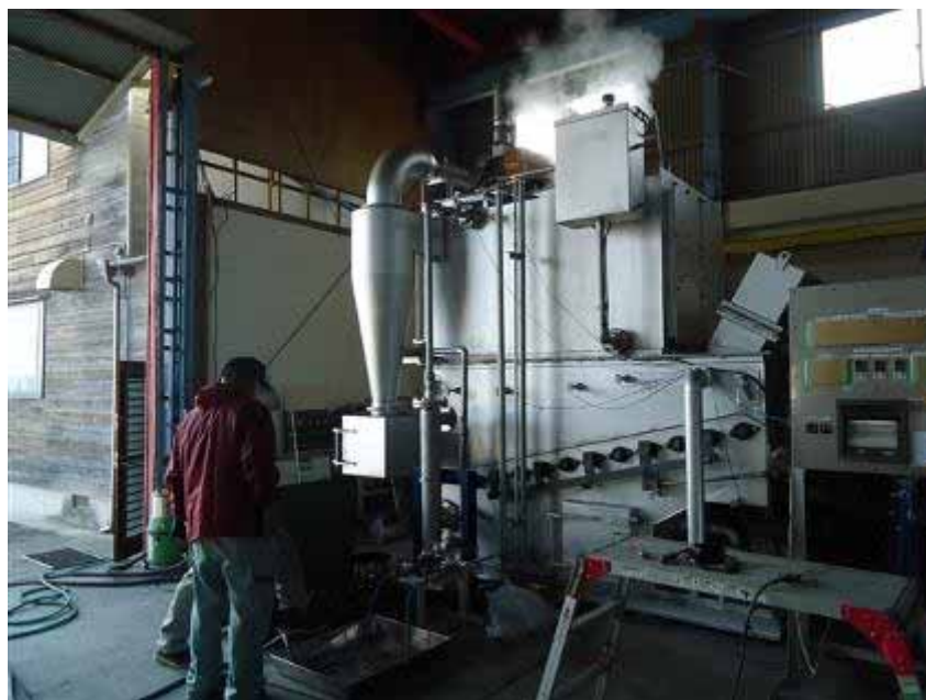
もみ殻ボイラー（試験機）
