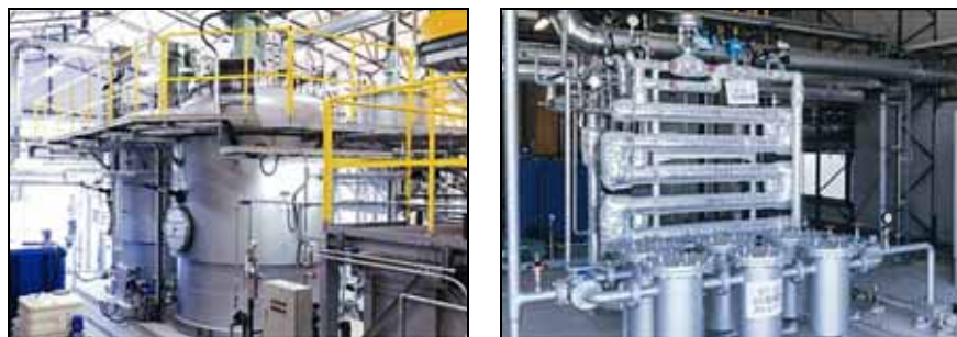
図 2-8 メタン発酵槽（左）、亜臨界水処理設備（右）
