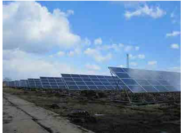
写真 1-9 郵船商事の太陽光発電システム
