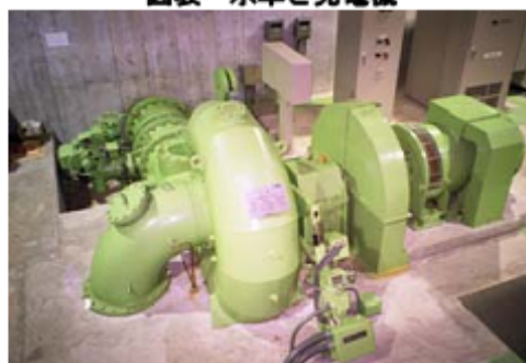
図表 水車と発電機
