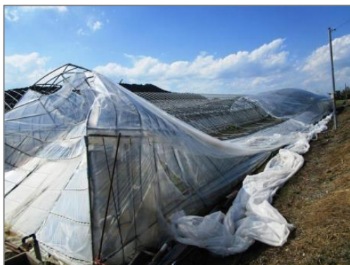
⑤ ビニールハウスの倒壊
