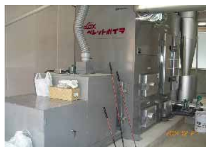
ペレットボイラー
