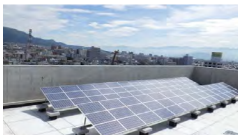
太陽光発電設備
