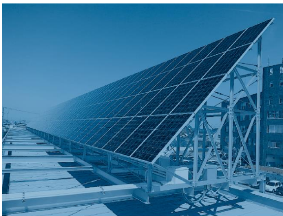
平川市役所の太陽光パネル
