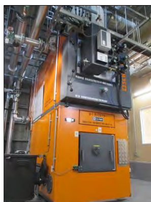
写真 1.6.1 バイオマスボイラー
