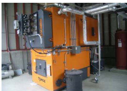
木質バイオマスボイラ
