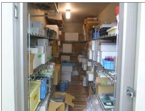
写真 4. 2. 2. 5 通常冷凍庫の例
