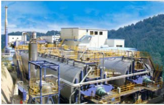
写真 4-12 CRPメタン発酵処理施設
