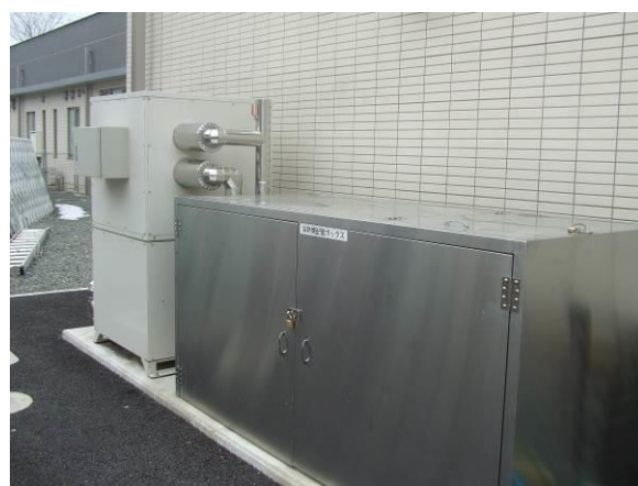
地中熱ヒートポンプ
