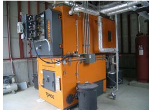
写真 4-4 木質チップボイラ 1 台で河鹿荘館内の暖房と浴湯の加温が可能
