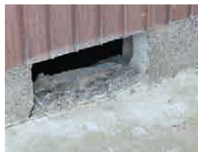
壊れた通風口
