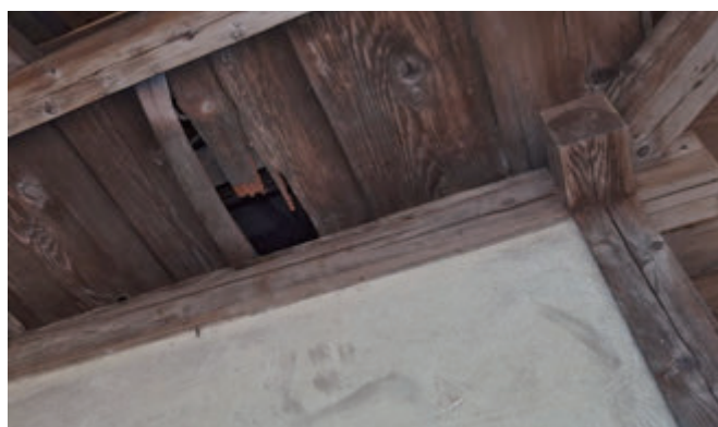
アライグマによる侵入場所の破壊被害
