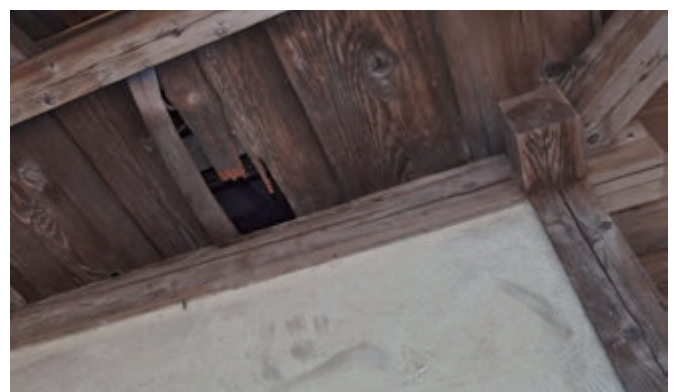
アライグマによる侵入場所の破壊被害
