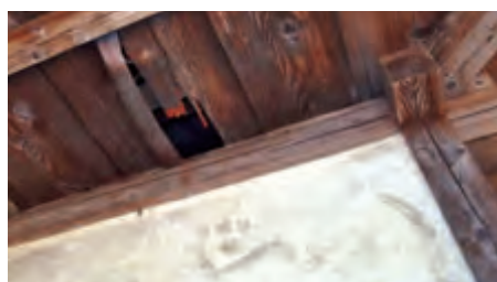
写真3 軒の壊れた場所は必ず狙われる
