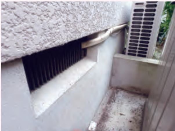
写真3 侵入口と糞被害
