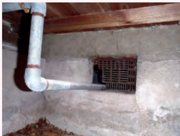
写真6 配管貫通穴侵入
