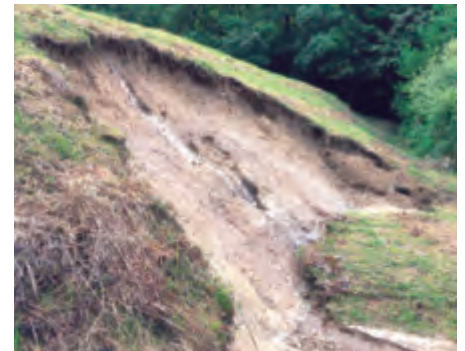
写真2-5-6 ヌートリアによる掘削が遠因となり引き起こされたため池堤体の部分崩落。岡山市北区横井上にある小幸田奥池にて(2018年の西日本豪雨災害時)。堤体内側の管理が不十分で藪化したためヌートリアを呼び込む形になってしまった。
