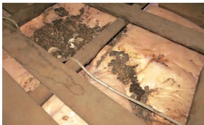
写真2-2-10 天井裏に堆積した糞尿
