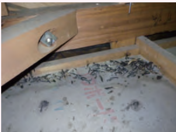
写真5 天井裏溜めファン被害
