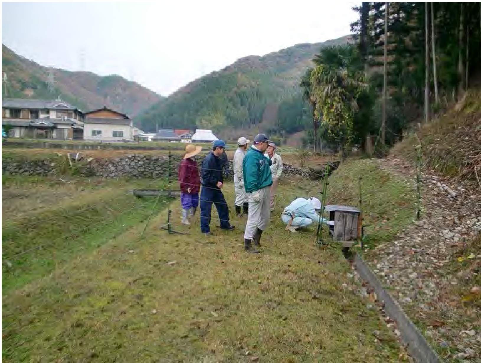
設置した電気柵は地域で点検
