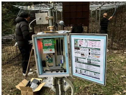
遠隔監視・自動操作システム
