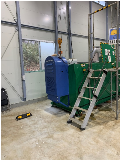
図 3. 減容化処理施設の内部
