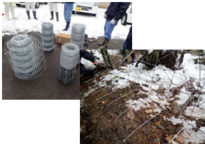
対策：柵の補強
