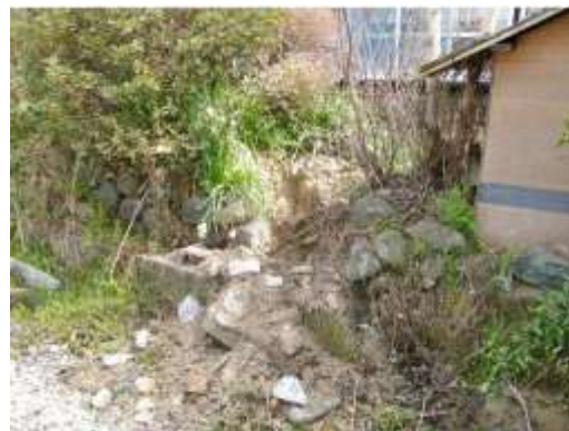
住居石垣の掘起し被害
