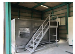
＜減容化処理装置＞
