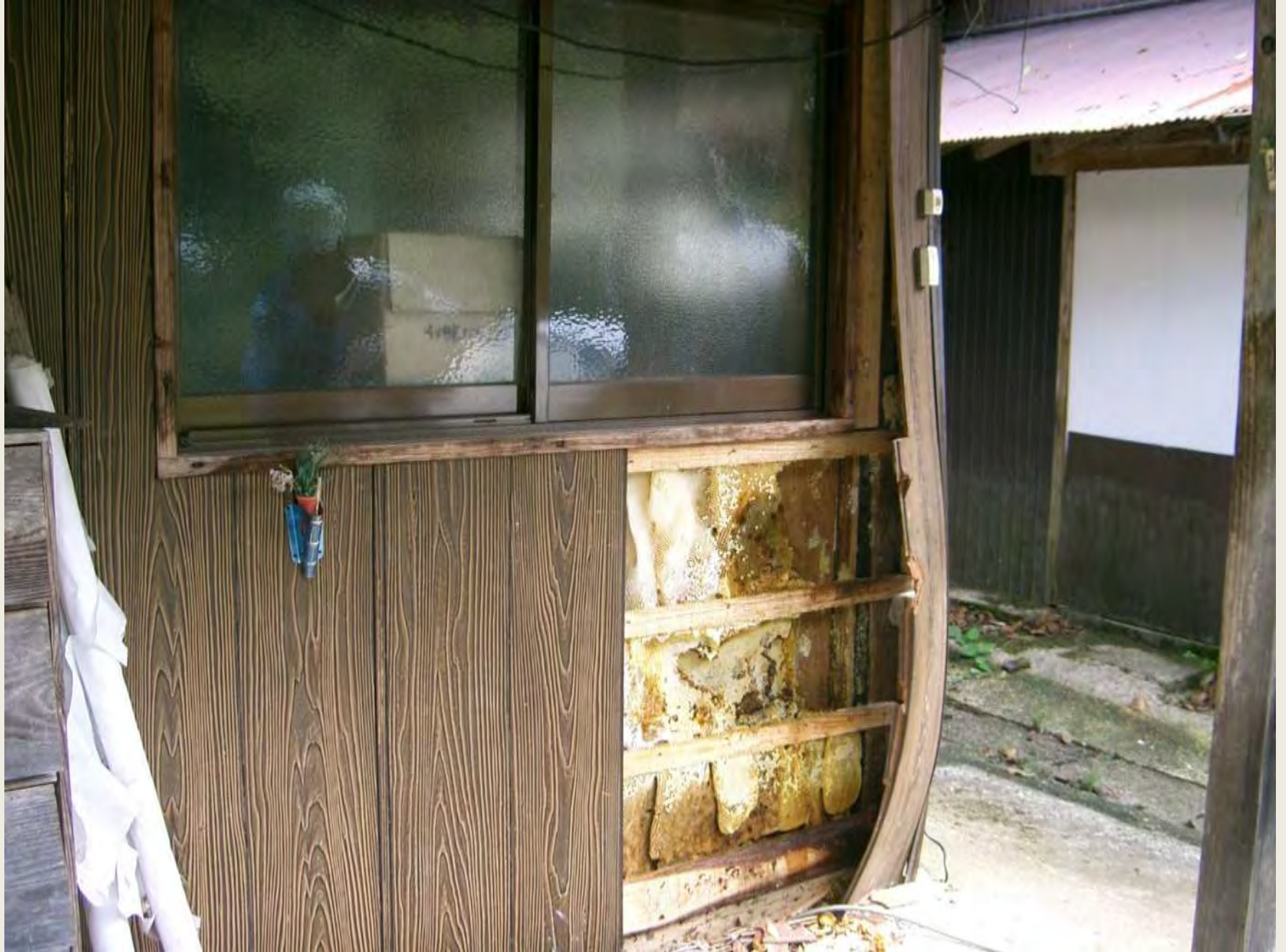
民家の壁に営巣した蜂巣の被害
