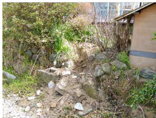
住居石垣の掘起し被害
