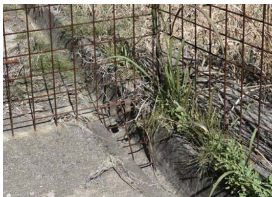
写真9 U字溝から潜りこませない工夫がされている
