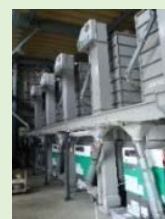
穀類乾燥調製施設
