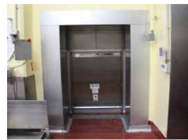
整備した不食エレベーター
