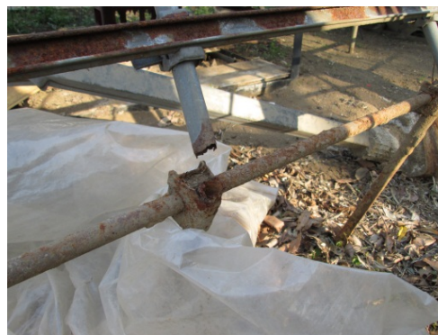
地際部の腐食による折れ
