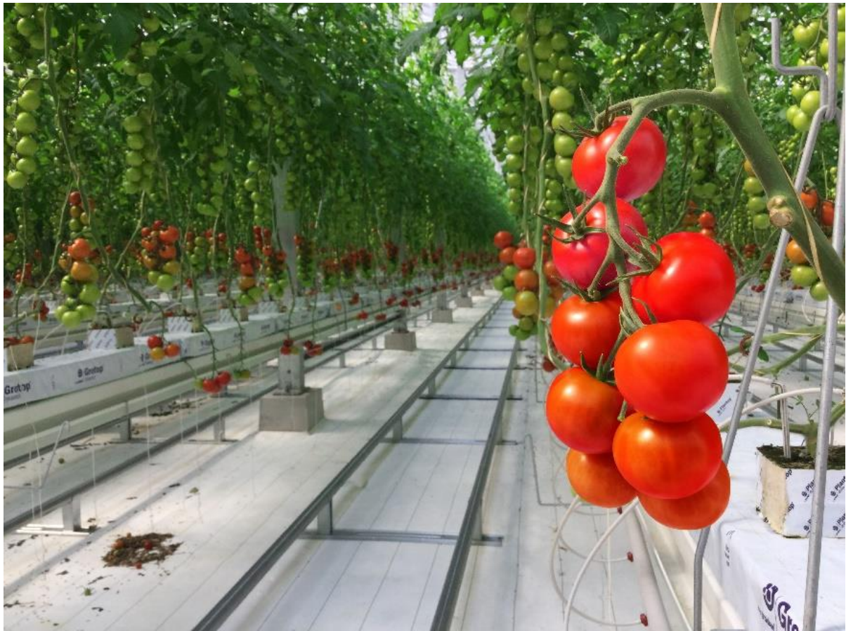
アグリビジョン施設 栽培風景/温湯暖房と各種作業台車の走行を兼ねたパイプレール 出所：サラダボウル提供
