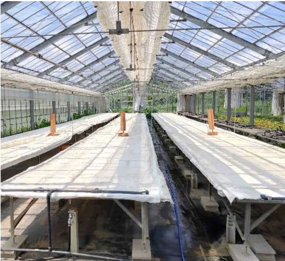
統合環境制御システムを導入した育苗ハウス
