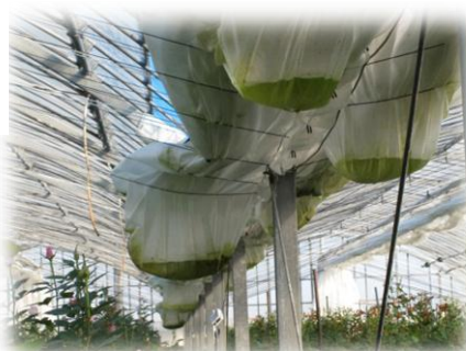
金魚鉢状に膨らんだ内張カーテン
